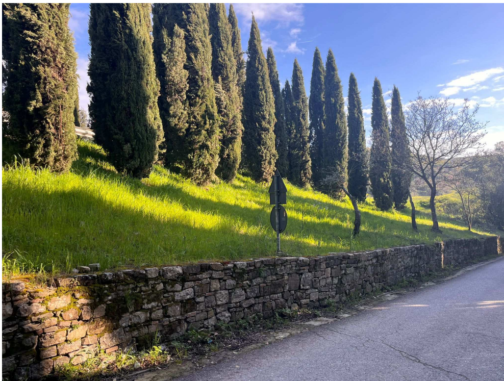
Muro a pietra che delimita la scarpata meridionale del parcheggio in progetto
